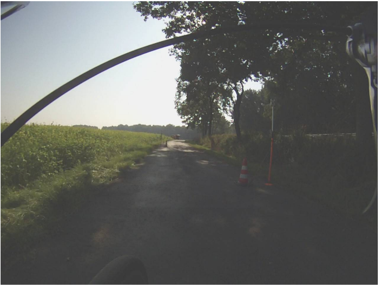
Bild 5: Das zur Absicherung aufgestellte Zeichen 123 Arbeitsstelle mit Zz Vermessung stand auf der Fahrbahn, die frei war. Und auch nur in Gegenrichtung. Auf dem Geh-/Radweg, dort wo die Hindernisse tatsächlich waren, wurde nicht gewarnt.
